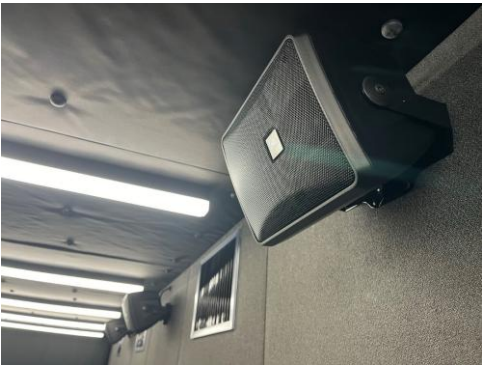
7.1chサラウンドに対応した音響システム
